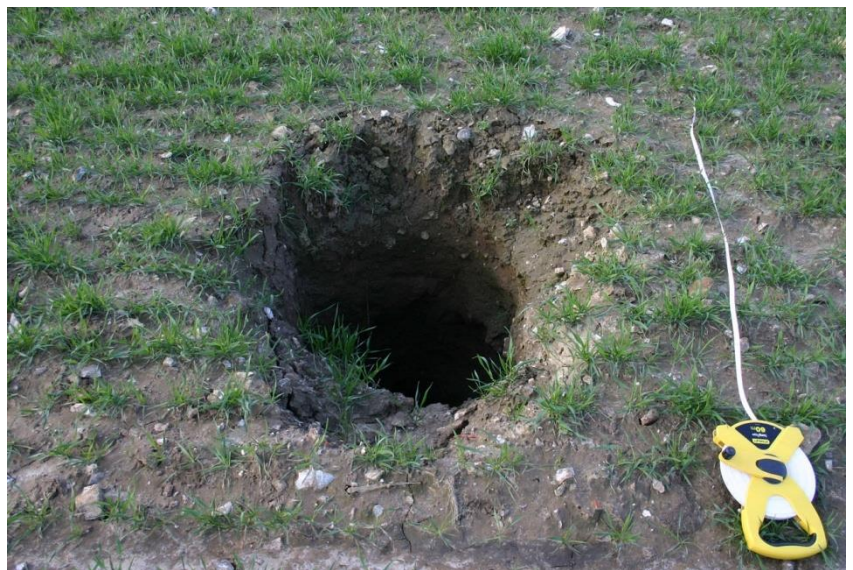
Illustration 80 : Effondrement d'une cheminée (source ALISE)
